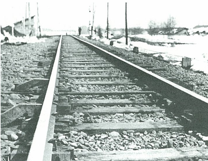
鉄道の路盤が凍上によって不整に隆起しレールに凹凸ができるのを修正するため枕木とレールの間に厚さ10cm余りの挟木を挿入してある。根室本線芽室駅構内（1950.3東晃撮影）
