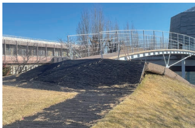
スロープと橋の間に大きな落差ができた
