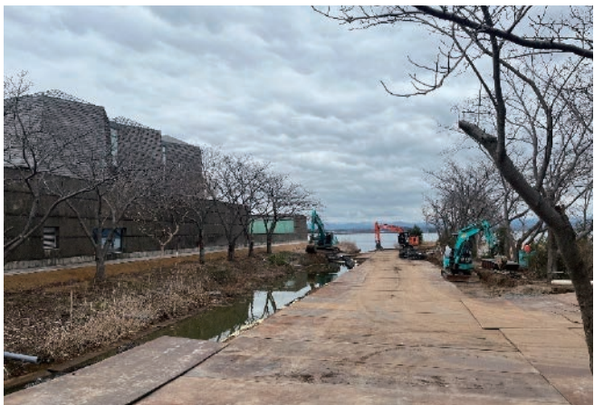
桜の木々が剪定され、川岸の歪みを整えるため、埋め立て工事が行われている。(2026年2月26日現在・館職員撮影)
